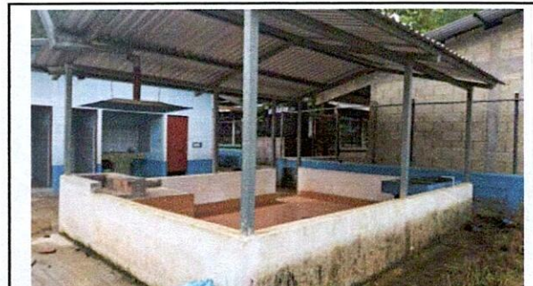
Foto 6: MODULO DE AULAS - Las instalaciones en si, no brindan las condiciones adecuadas al los niños (as)
